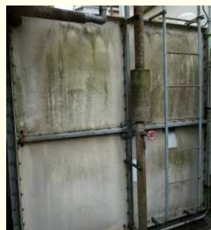
給水配管設備の劣化が懸念されます
