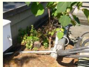
屋上に植物が繁殖しています
