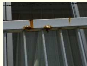
てすりに腐食があります
