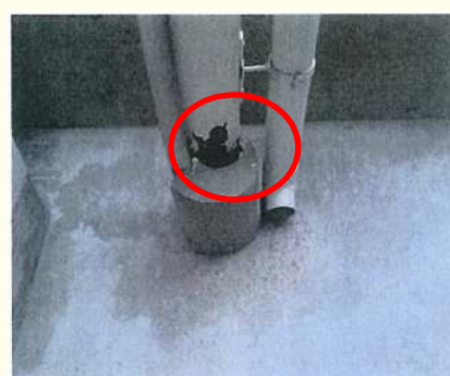
消耗や経年劣化による損害
