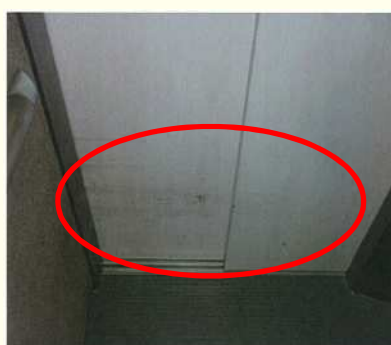
機能に支障のない汚れ
