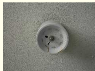
非常用照明が点灯不良です
