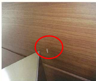
機能に支障のない傷
